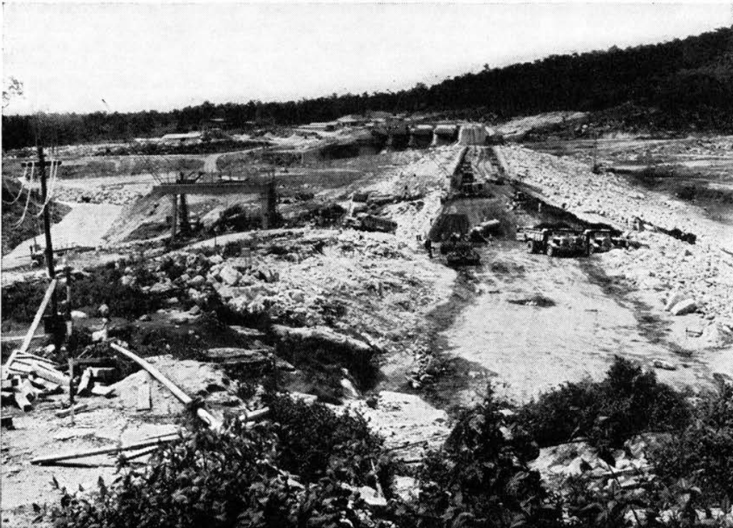
Gesamtansicht des mit deutscher Kapitalhilfe entstehenden Nam-Pong-Projektes als Teil des Mekong-Gesamtprojektes (vgl. hierzu auf der beigefügten Karte Seite 132 die Lage im östlichen Thailand).
